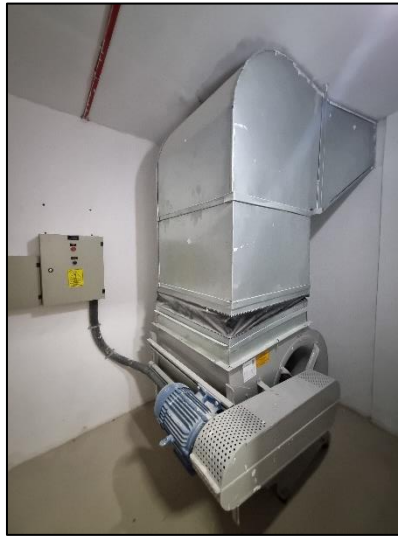
Máquina de pressurização da escada de emergência
