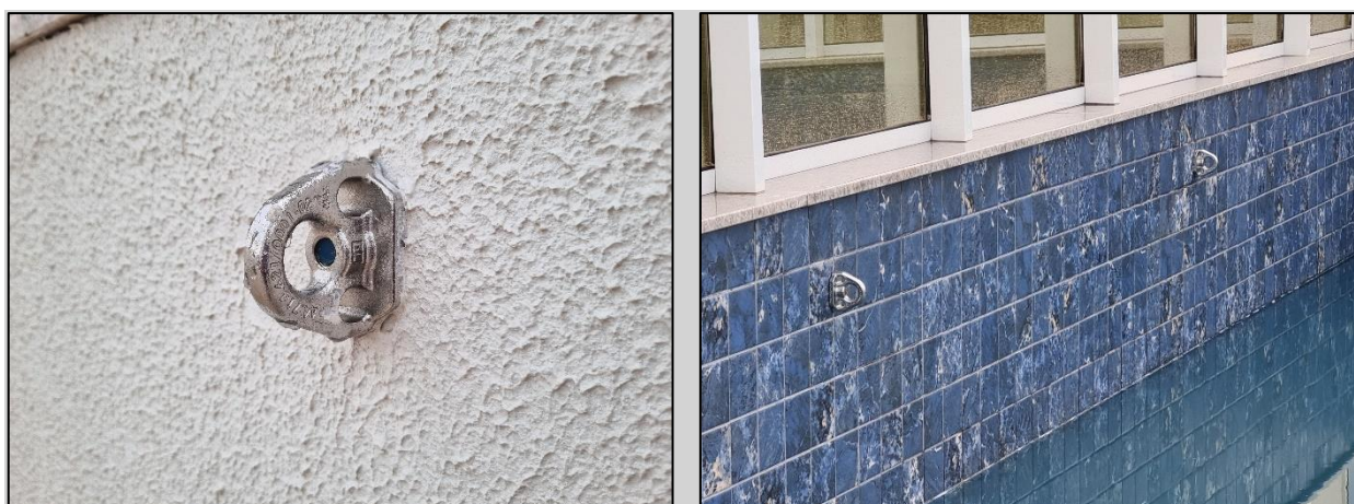
Dispositivo de ancoragem instalado na platibanda no pavimento lazer
