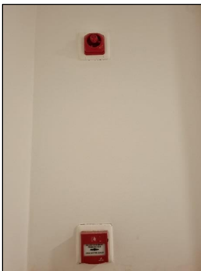
Alarme de incêndio
