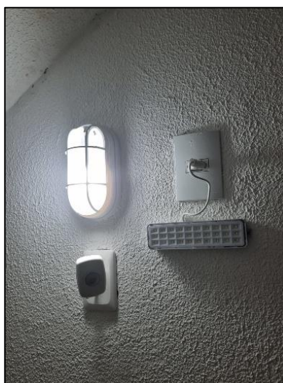
Iluminação de emergência
