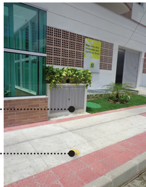
Figura 88 | Central de gás
