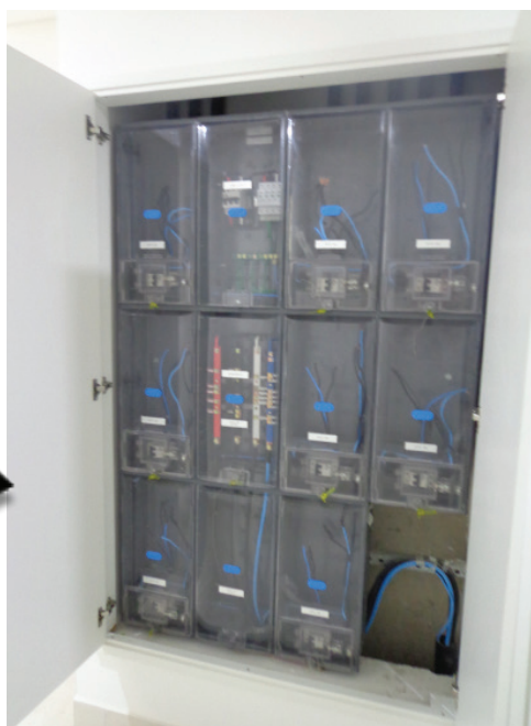
Figura 78 | Medidores dos apartamentos
