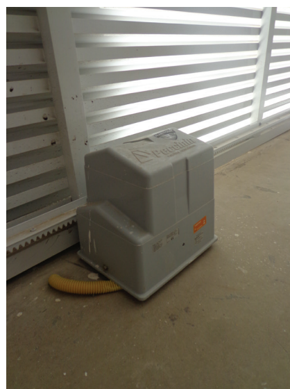
Figura 98 | Motor de acionamento do portão de correr de acesso a garagem do térreo
