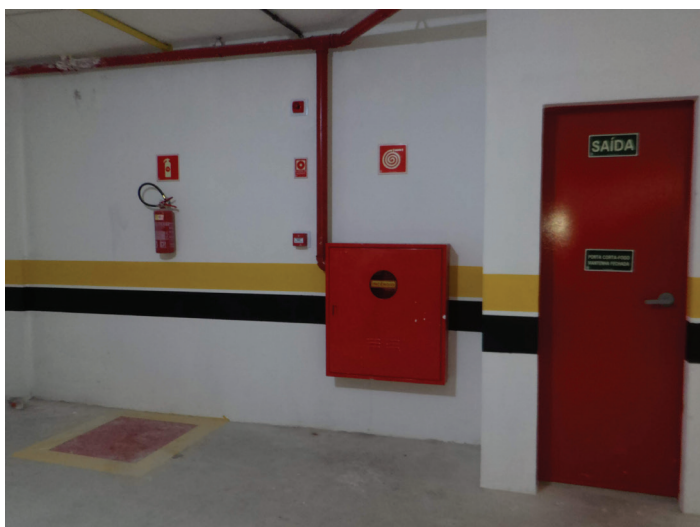
Figura 108 | Hidrante na garagem
