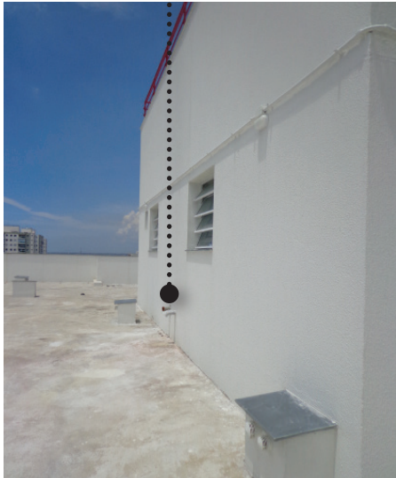
Figura 50 | Tubulação de limpeza e extravasor do reservatório superior
