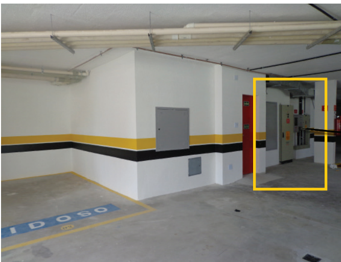
Figura 72 | Instalações elétricas na garagem do pavimento térreo
