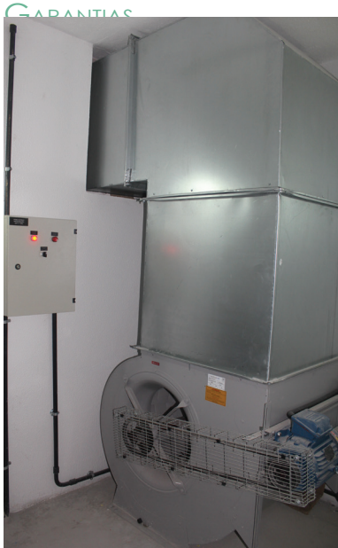
Figura 115 | Motoventilador do sistema de pressurização
