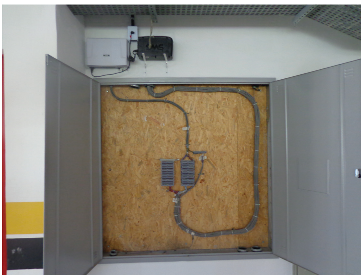
Figura 106 | Detalhe da caixa de distribuição geral (telemática) no térreo
