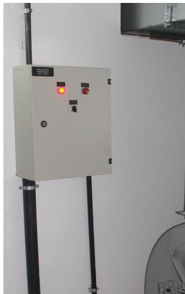
Figura 116 | Quadro de comando do sistema de pressurização
