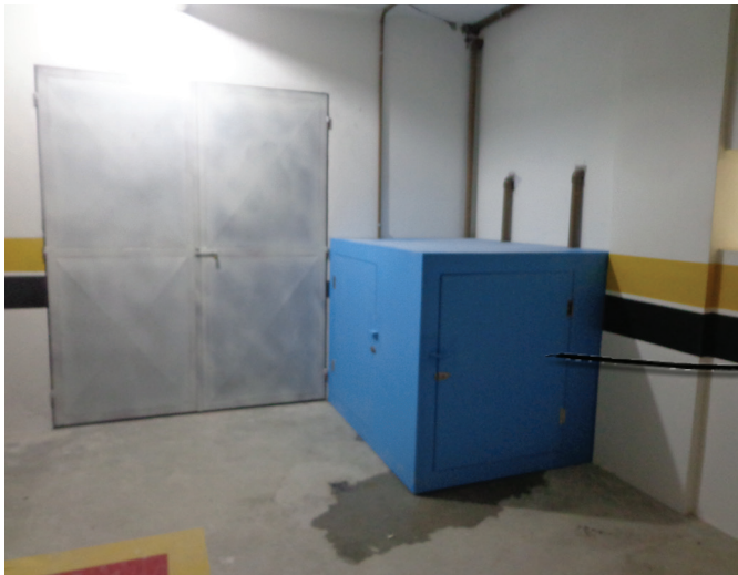
Figura 127 | Armário em fibra para equipamentos da piscina
