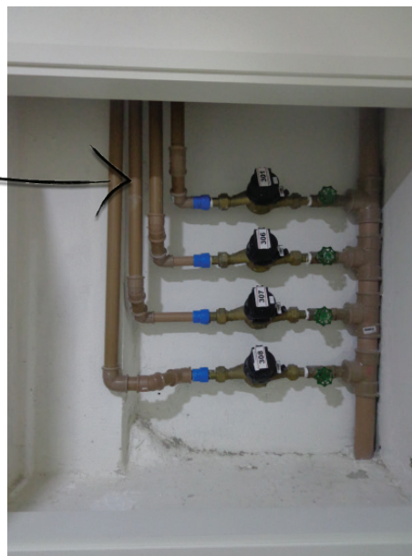
Figura 54 | Detalhe dos hidrômetros individuais
