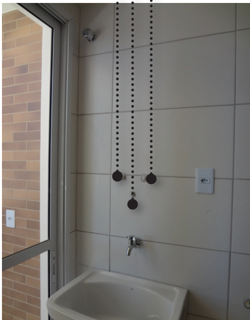
Figura 92 | Local de instalação do aquecedor á gás na área de serviço do apartamento
