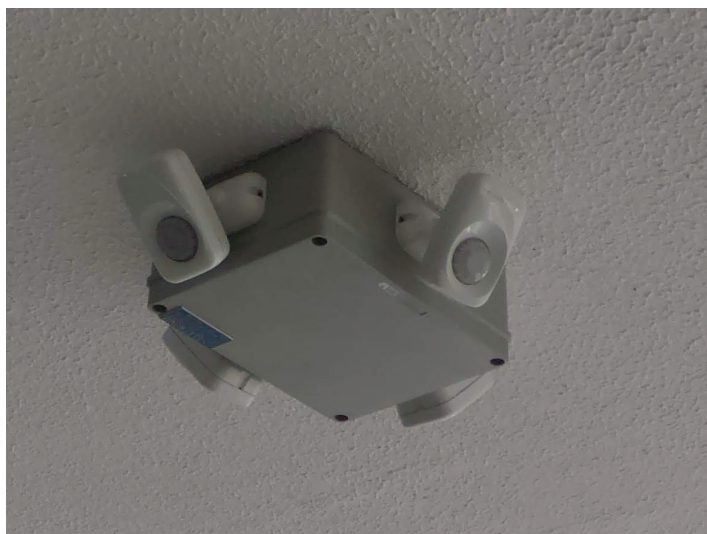
Figura 79 | Sensores de presença no teto da garagem
