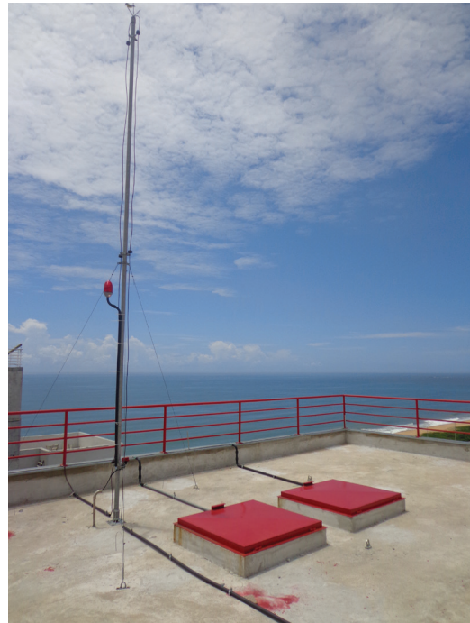
Figura 94 | Captador Franklin na laje de tampa do reservatório superior
