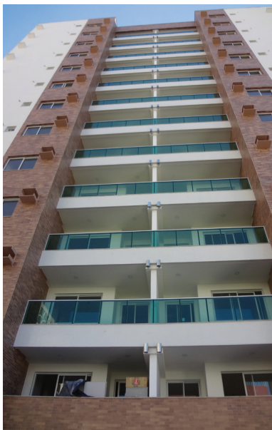
Figura 81 | Caixas de ardósia para máquinas do ar condicionado
