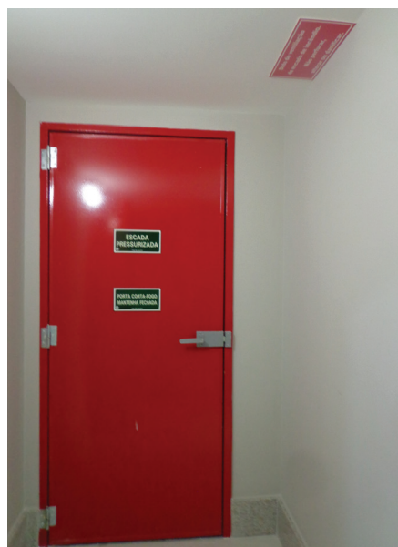
Figura 121 | Porta corta fogo
