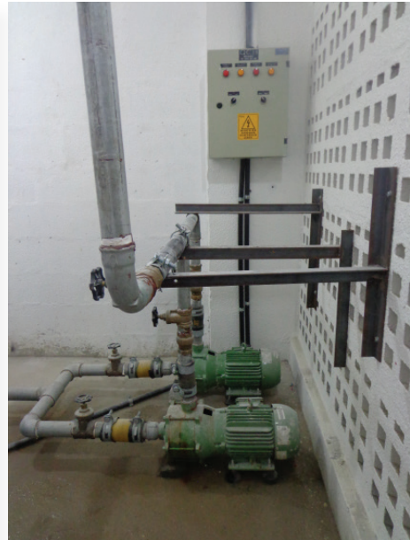
Figura 48 | Quadro de comando e bombas de recalque do sistema de água potável
