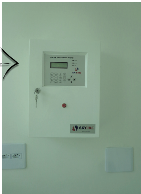
Figura 113 | Central de alarme
