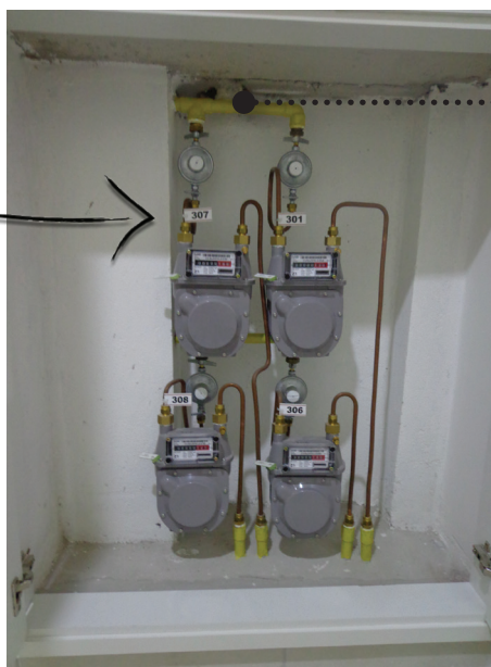
Figura 90 | Detalhe dos medidores individuais
