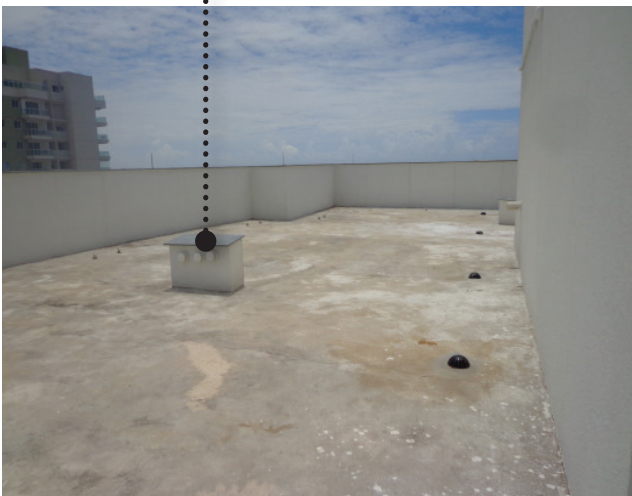
Figura 60 | Detalhe da saída da coluna de ventilação no telhado
