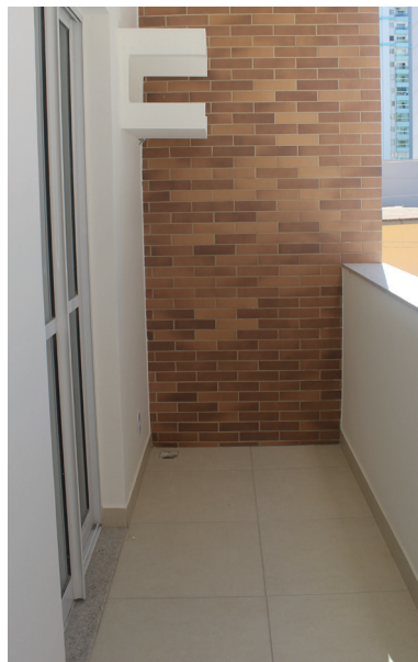
Figura 82 | Caixa do ar condicionado na varanda do apartamento
