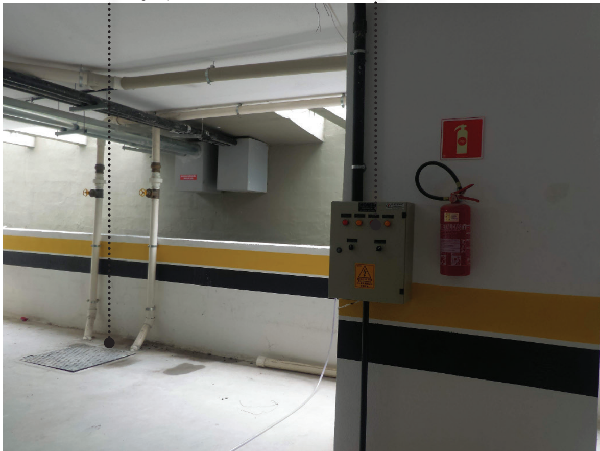
Figura 59 | Poço de recalque de água pluvial no subsolo e quadro de comando
