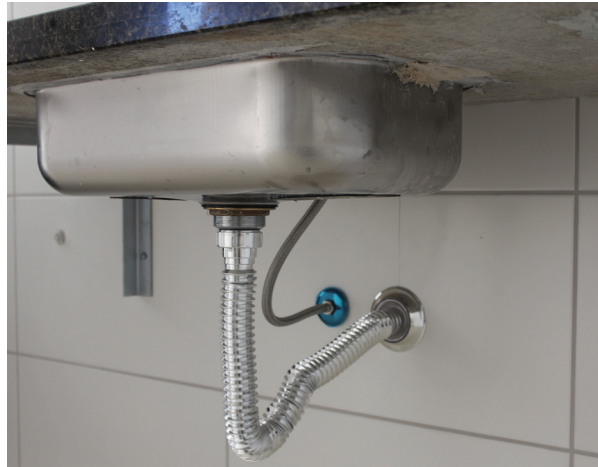
Figura 71 | Sifão em PVC cromado na cuba da pia da cozinha
