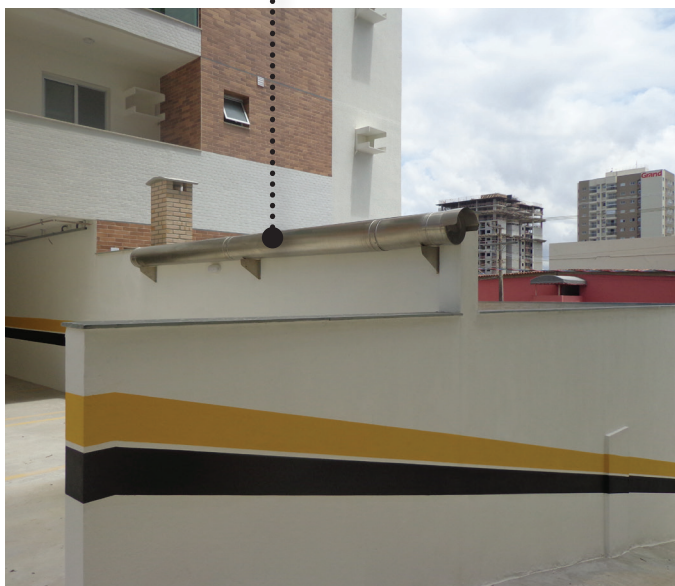
Figura 33 | Duto de exaustão da churrasqueira em aço inox
