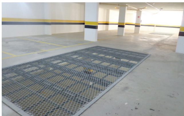
Figura 30 | Grelha de ventilação e iluminação no pavimento térreo
