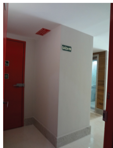
Figura 120 | Duto do sistema de pressurização portaria
