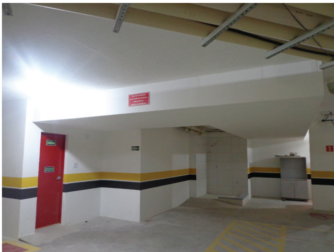
Figura 119 | Duto do sistema de pressurização na garagem do pavimento térreo
