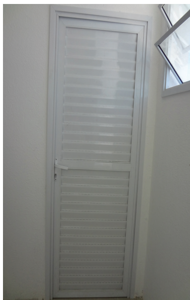
Figura 23 | Porta no pavimento cobertura em alumínio
