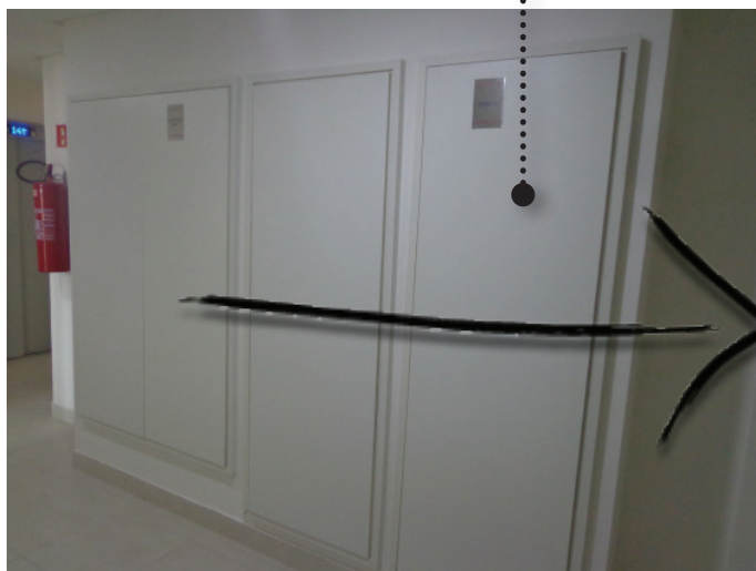
Figura 77 | Armário de medidores no hall dos pavimentos
