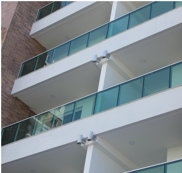
Figura 85 | Sistema de exaustão na fachada da edificação
