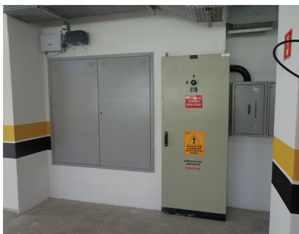
Figura 104 | Caixa de distribuição geral (telemática) de telefonia no térreo
