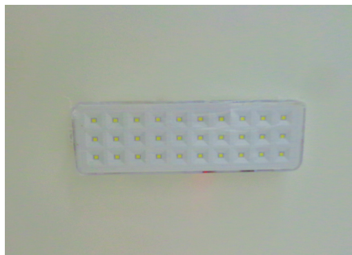
Figura 111 | Iluminação de emergência
