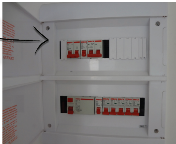
Figura 75 | Detalhe do quadro de distribuição aberto dos apartamentos
