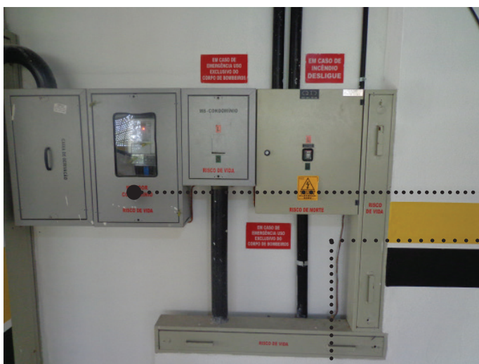
Figura 76 | Medidor do condomínio no pavimento térreo
