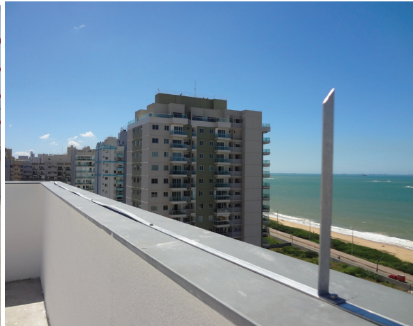
Figura 96 | Gaiola de Faraday na platibanda da cobertura
