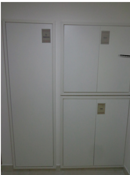
Figura 53 | Medidores individuais dos apartamentos no hall dos pavimentos tipo
