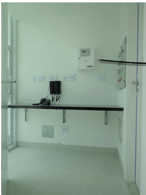
Figura 112 | Central de alarme na guarita
