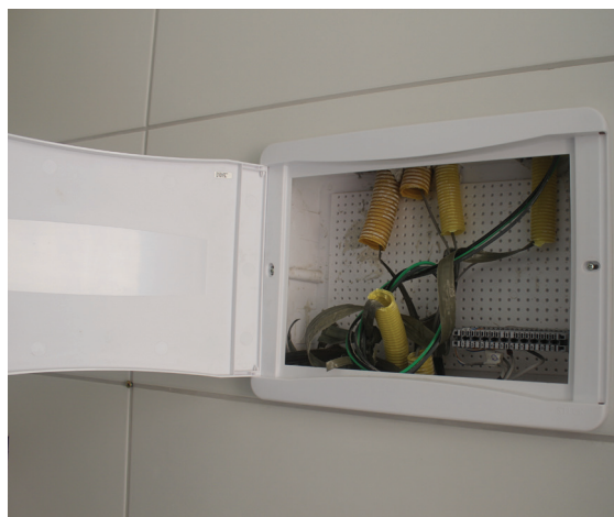
Figura 105 | Quadro de conectividade na cozinha dos apartamentos
