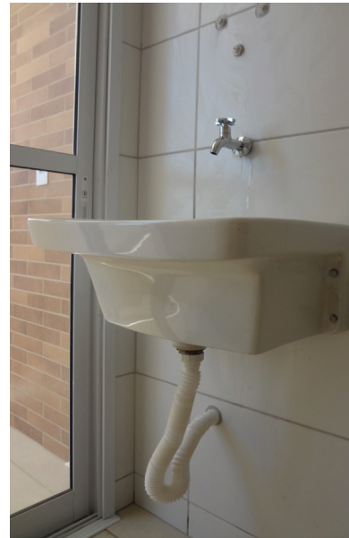
Figura 65 | Tanque em louça na área de serviço dos apartamentos
