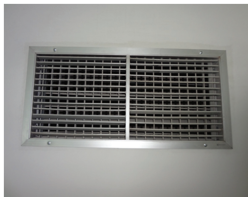
Figura 31 | Grelha de ventilação da escada pressurizada
