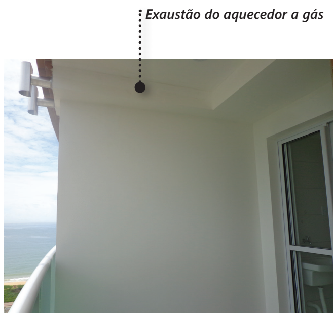
Figura 93 | Detalhe de gesso na varanda do apartamento para duto de exaustão do aquecedor
