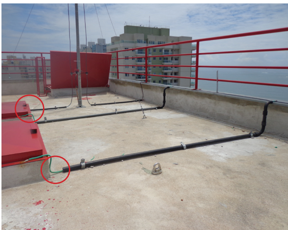
Figura 95 | Aterramento nas tampas da caixa d'água
